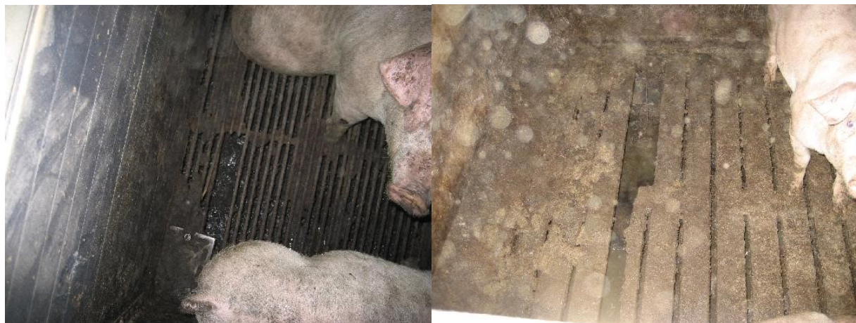
Foto 5.1.1: Defekt jernspaltegulv tv. og defekt betonspaltegulv th.
